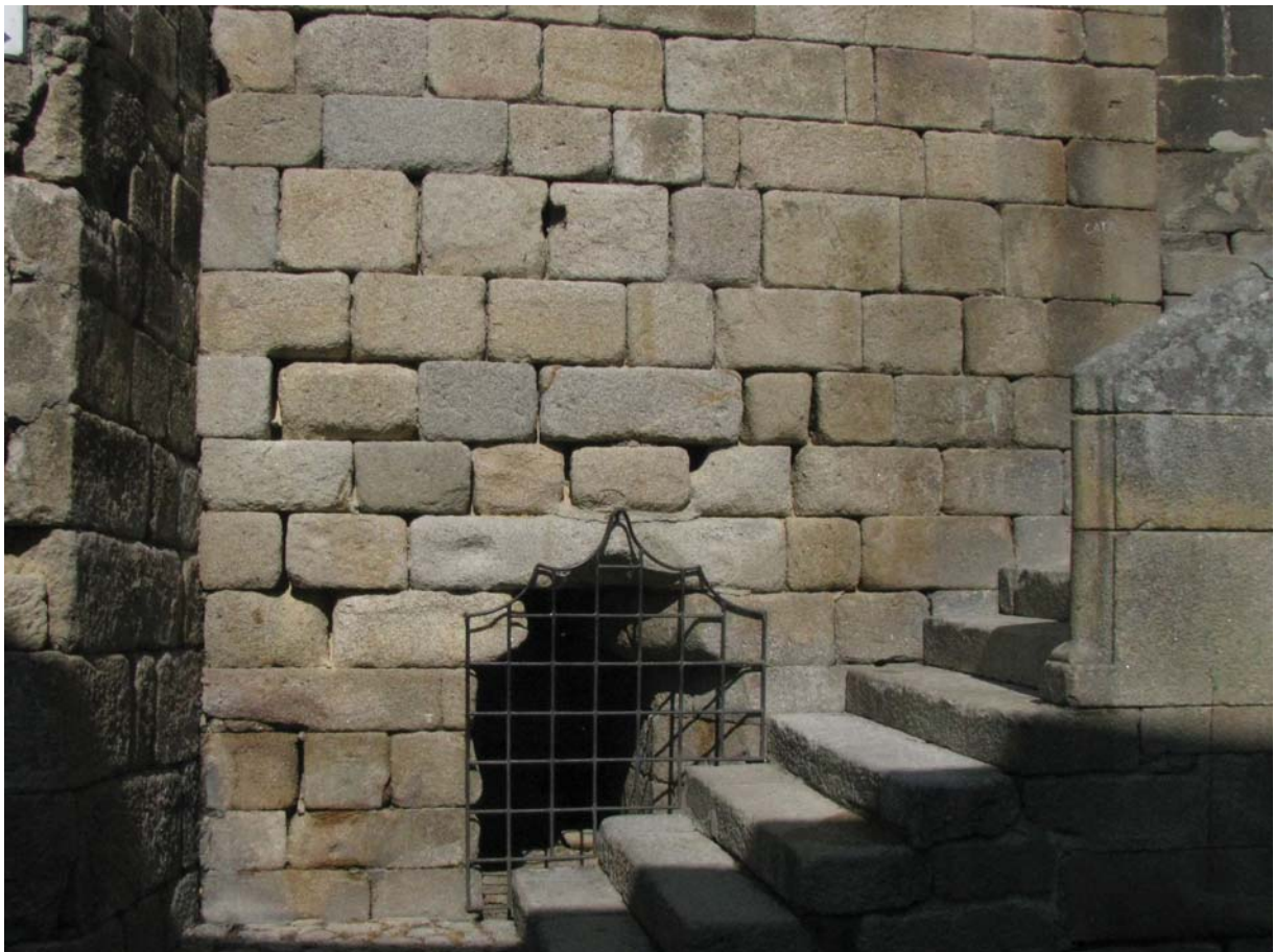
Fig. 8. Padrões de erosão em parede sugestivos da migração da poluição salina (a erosão dos blocos diminui com a altura e é mais acentuada ao longo dos limites entre estes).
