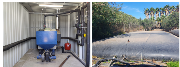
Figura 2: Sistemas de aporte de energía térmica y refrigeración. Imagen de la izquierda: caldera de biomasa, imagen de la derecha: depósito de agua de mar.
