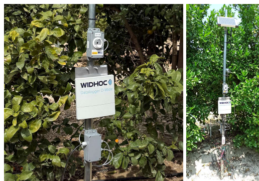
Figura 1: Instalación de sensores y dataloggers en campo.
