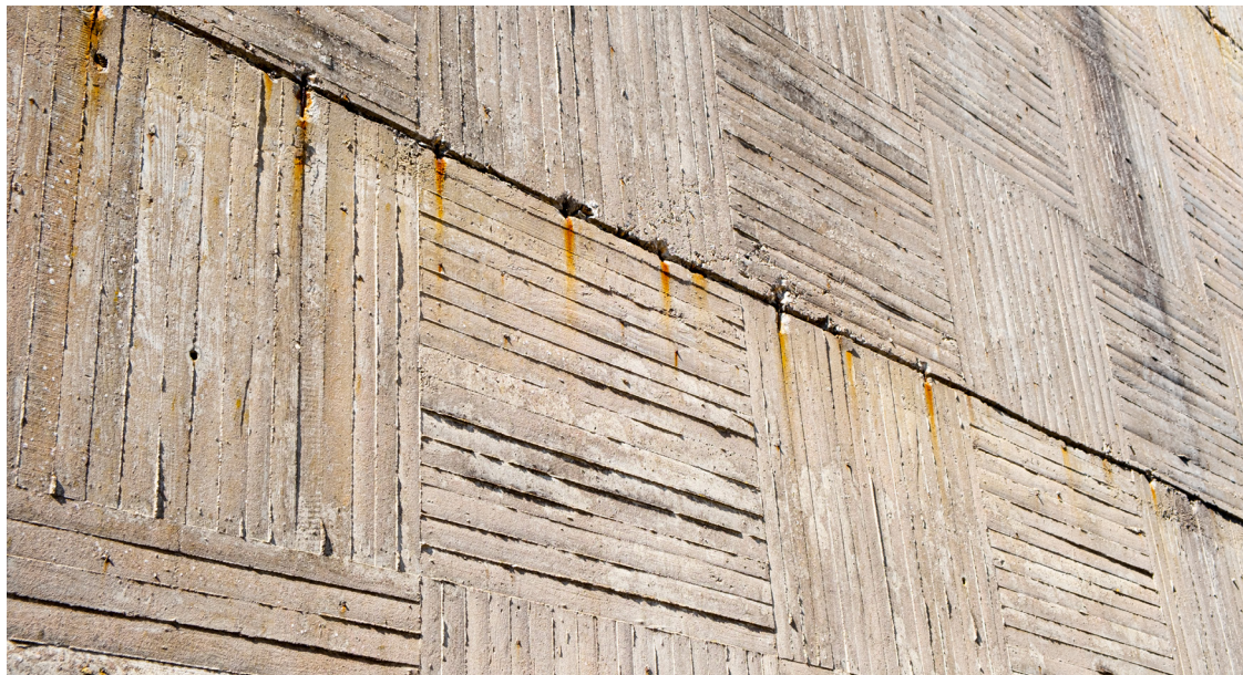
Imagen 3. Detalle de hormigón a la vista con marcas del forjado. Guillermo Calviño
