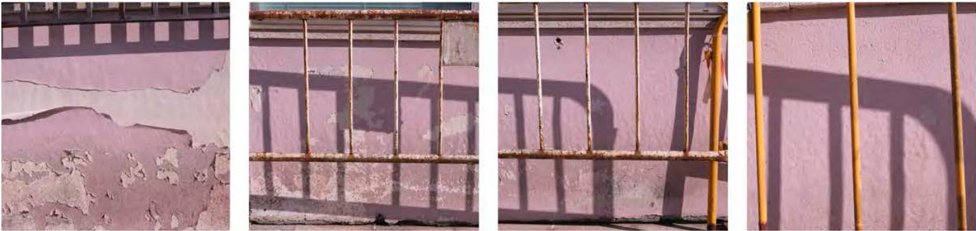
Imagen 15. Desconchados y vallas sobre fondo rosa característico del edificio
